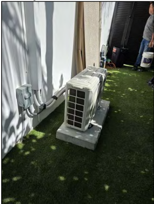
Condenser unit for the mini split system
